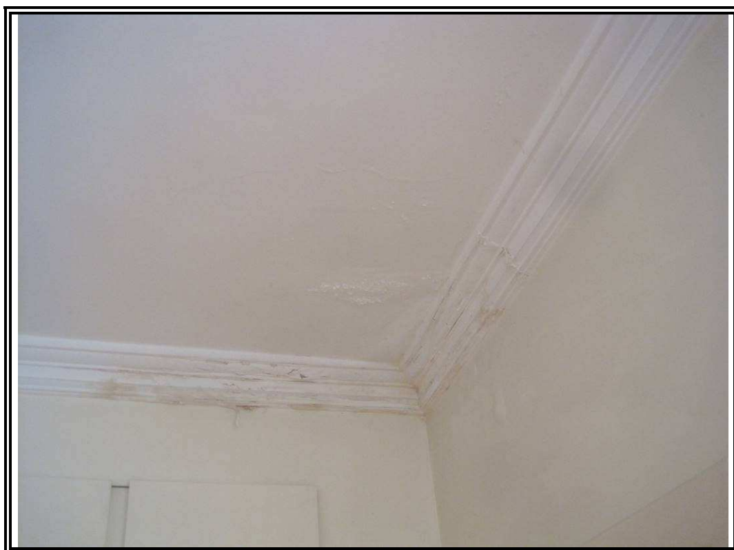
Foto nº 28: Detalhe da infiltração existente no forro do dormitório 03 (suíte)
