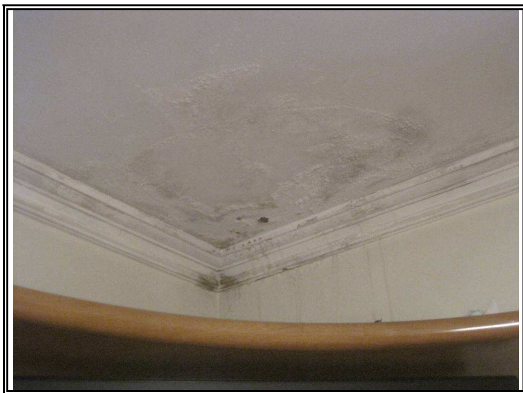
Foto nº 25: Detalhe da infiltração existente no forro do dormitório 02 (suíte)
