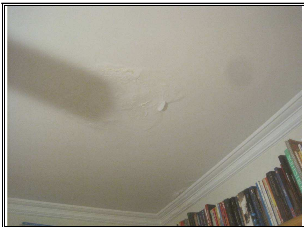
Foto nº 14: Detalhe de infiltrações presentes no forro da antessala
