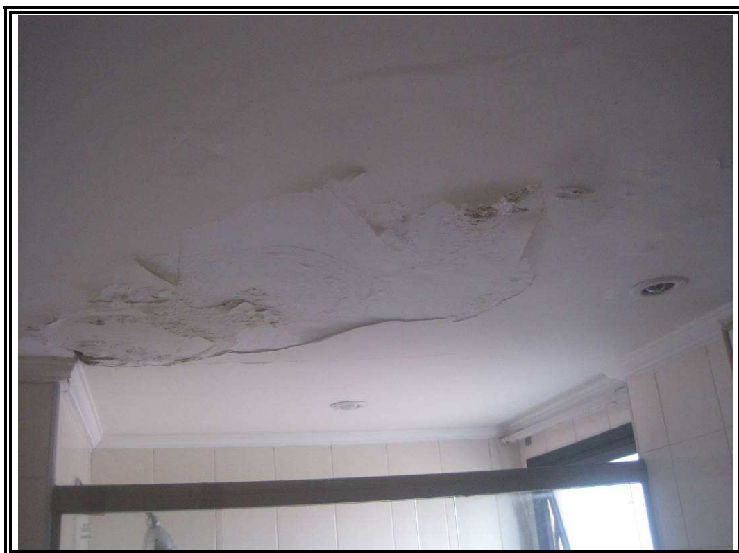
Foto nº 20: Detalhe da infiltração existente no forro do banheiro do dormitório 01 (suíte máster)
