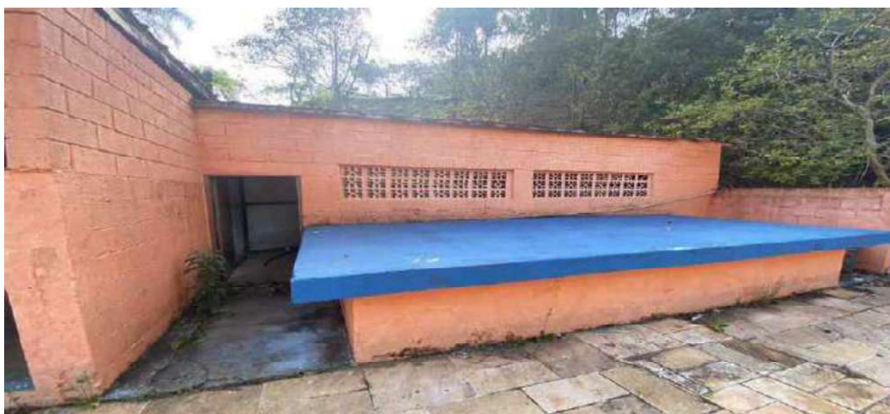
VISTA CASA DE MÁQUINAS PISCINAS
