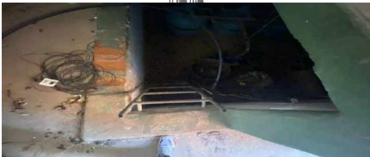
VISTA CASA DE MÁQUINAS PISCINAS
