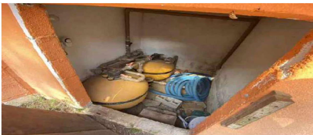
VISTA CASA DE MÁQUINAS PISCINAS
