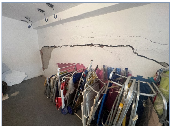
Foto 6 – Trinca junto ao depósito no térreo
