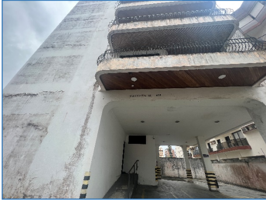
Foto 1 – Vista da fachada frontal, necessitando de manutenção
