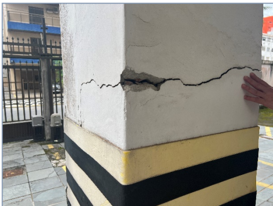
Foto 3 – Vista do pilar do edifício necessitando de reparos estruturais
