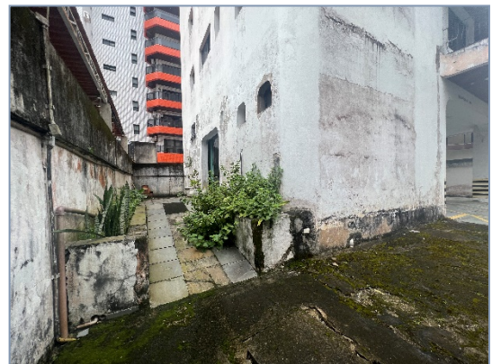
Foto 4 – Recuo lateral do prédio necessitando de obras de manutenção
