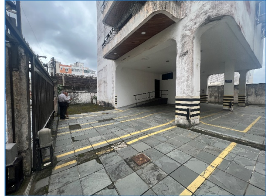
Foto 2 – Vista da garagem térrea e fachadas necessitando de manutenção
