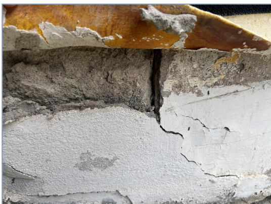
Foto 5 – Corrosão de armadura em peça estrutural
