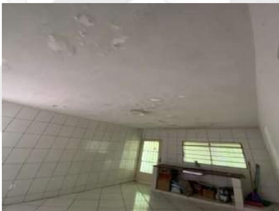
Vista geral da cozinha com diversos problemas de umidade e infiltrações nas paredes e laje.
