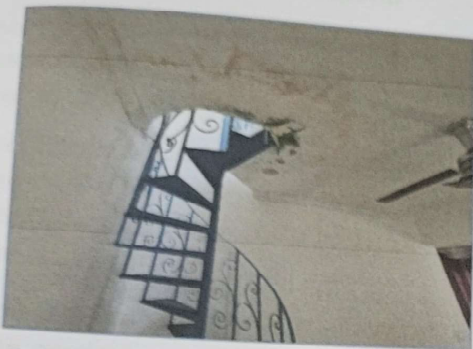
Foto 7 – Escada de acesso ao pavimento superior, com infiltração e bolor
