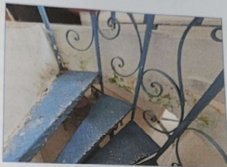
Foto 8 – Escada de acesso ao pavimento superior, com infiltração e bolor
