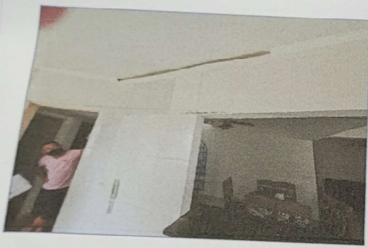
Foto 3 – Infiltrações, estufamento e queda de revestimento cerâmico, queda de moldura de gesso junto a cozinha
